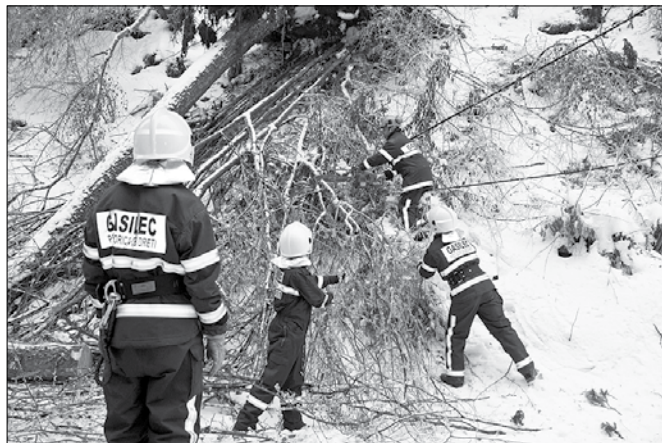
Gasilci PGD Gorica ob Dreti so odstranjevali drevesa, ki so poškodovale električne vode na zelo težko dostopnem terenu. (Foto: MŠ)
