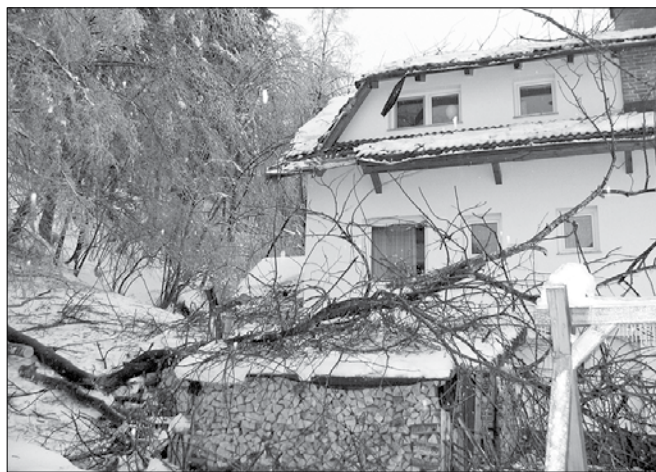
Padla drevesa so poškodovale otroško sobo, garažo, drvarnico, fasado, strešnike, žleb, ostrešje ... (Foto: Štefka Sem)
