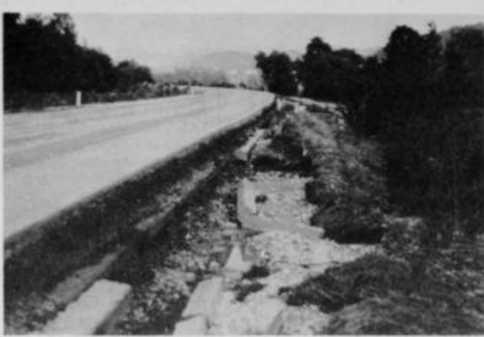
Komaj obnovljena cesta je poškodovana tudi na vsej poti med haloškimi griči.
