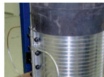
Kondenzator (aluminijasta roll bond plošča, enostransko napihnjena), ovit okrog rezervoarja tople sanitarne vode
