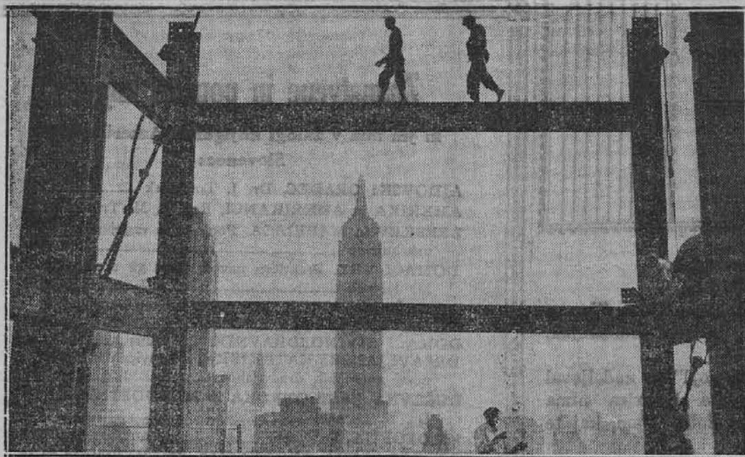
Slika nam kaže dva delavca v vrtohlavi višini, ki sta zaposlena pri gradbi nekega 70nadstropnega poslopja v New Yorku. V ozadju se vidi nebotičnik Empire State Building.
