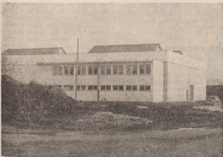
Podjetje INDOS je zgradilo novo halo, ki zanj pomeni pomemb- no pridobitev
