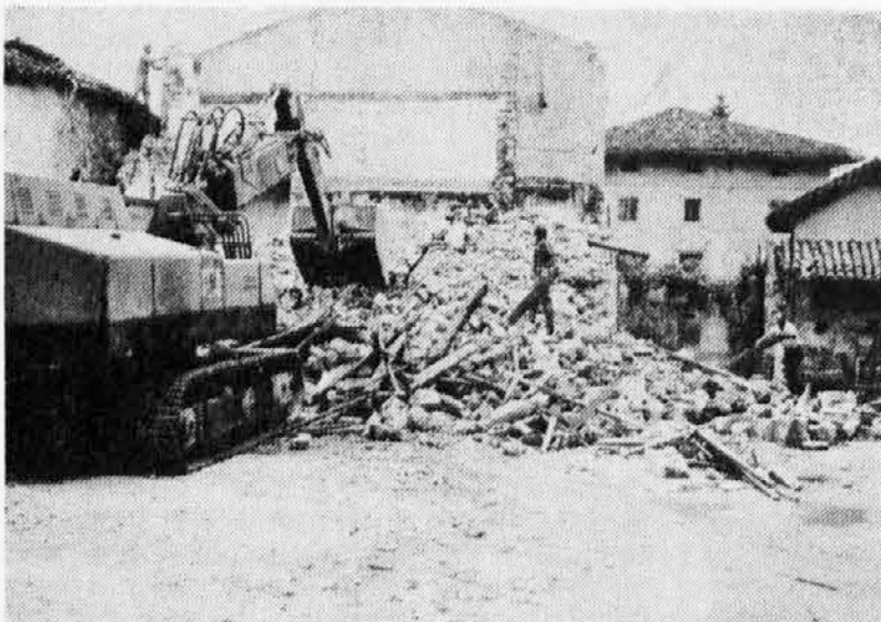
V Dolenjem Barnasu podirajo hiše, ki so ble huduo poškodovane od potresa
