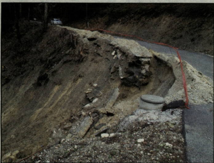
Poškodovani del ceste Spodnja hosta-Urankar, za katero na Občini Tabor ocenjujejo, da bo zaradi tega, ker se je plaz sprožil na delno že saniranem manjšem plazu, sanacija zahtevnejša, kot so predvidevali.
