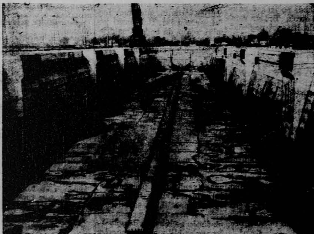
V angleškem pristanišču Southampton je največji suhi dok za čiščenje in popravljanje parnikov. Širok je 135, dolg pa 1200 čevljev. Ter je zgrajen iz betona.
