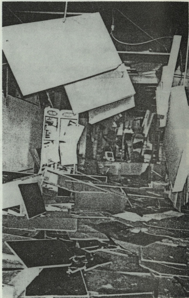
Slika 15. Nekonstrukcijska škoda v notranjosti veleblagovnice [4]
