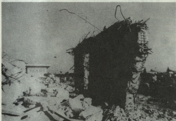
Slika 10. Povezave med montažnim okvirom in nosilnimi stenami so bile slabe
