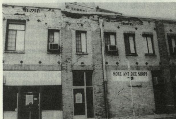
Slika 13. Poškodbe zidane stavbe z notranjščino na sliki 12
