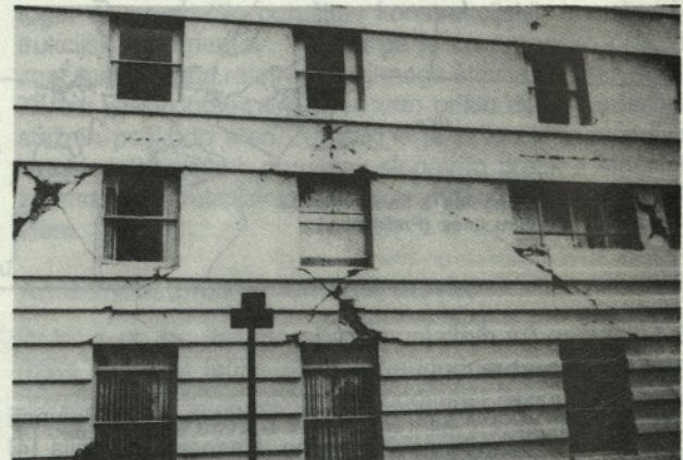
Slika 8. Strižne poškodbe stene
