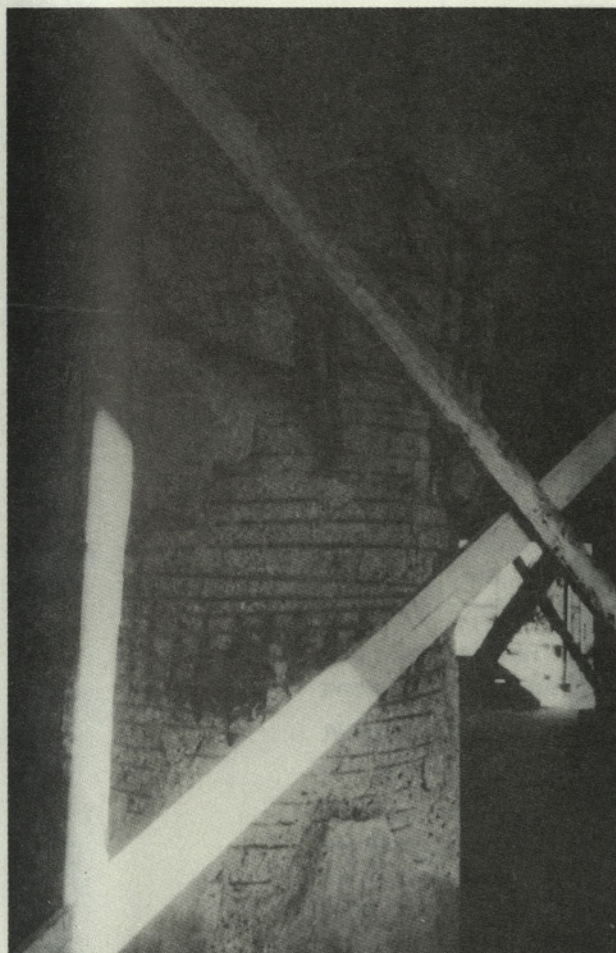
Slika 21. Strižna porušitev mostnega stebra z vuto
