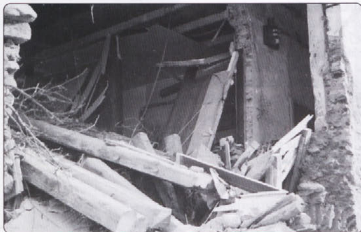
Kar se je že dolgo napovedovalo, se je v začetku marca, žal, res zgodilo - zrušilo se je stanovanje v Dominikanskem samostanu v Radljah ob Dravi. V dotrajanih, nevarnih stanovanjih živijo socialno ogrožene družine, ki nimajo kam drugam. Ob nesreči (na srečo) sicer nihče ni bil poškodovan, strah se pa se je še bolj zaril v kosti stanovalcev. Kdaj lahko sledi še večja katastrofa? Posnetek Kristl Valtl
