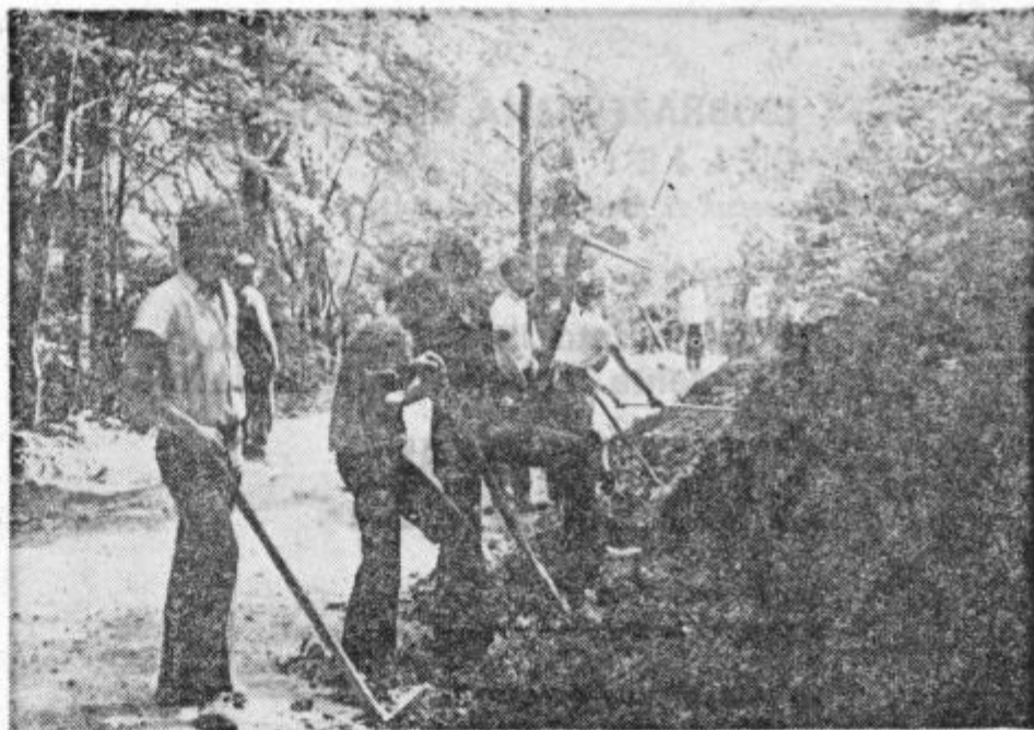
Vsako nedeljo, pa tudi med tednom, je pri rekonstrukciji ceste iz Svibnega v Jagnjenico vedno veliko prostovoljcev, ki bodo k vrednosti nove ceste prispevali vsaj dobro polovico.
