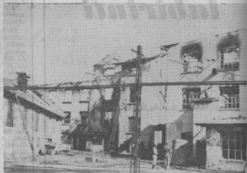
Ožgane stene, neme priče strašnega požara
