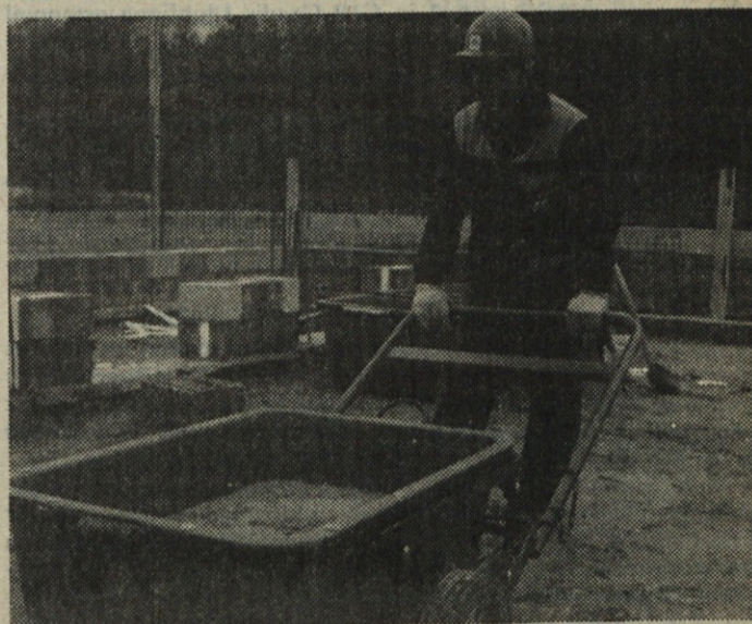
Plastična posoda na posebnem vozičku je namenjena za prevoz malte po gradbišču.
