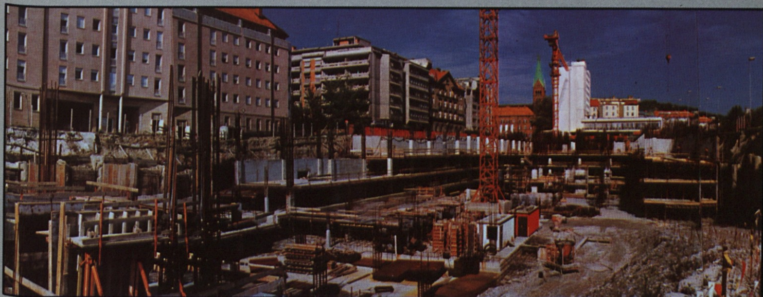
Gradbišče podzemnih garaž ob Hotelu Slavija v Mariboru je sedaj varno, ponovno pa je zmanjkalo denarja za nadaljevanje gradnje.
