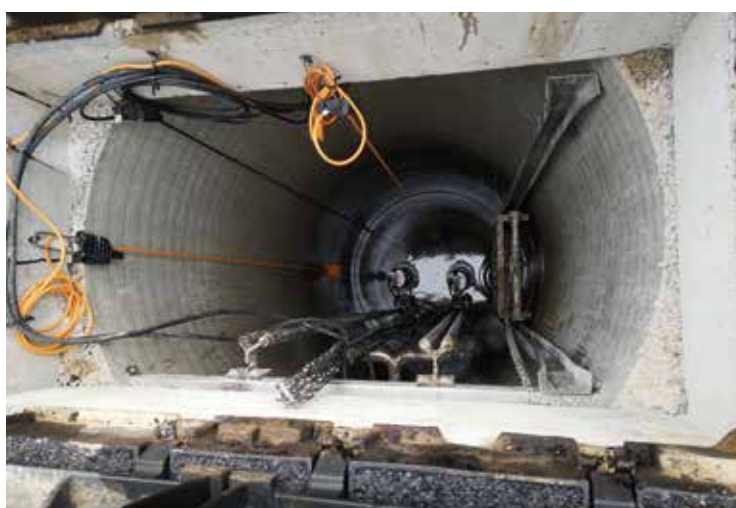
Kanalizacijsko črpališče v Podkraju
