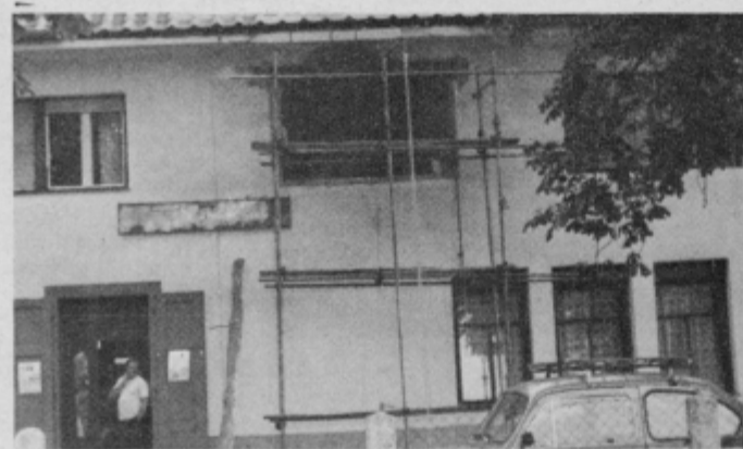
Streho so že uspeli popraviti, prvo nadstropje, kjer je mina naredila veliko luknjo, pa bodo popravili v teh dneh. (Foto VT)
