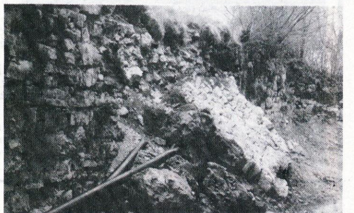
Del podrtega obzidja na severni strani podružnične cerkve sv. Marjete na Gradišču. Da bi cerkev, dragocen kulturni spomenik iz gotskega obdobja zavarovali, bo potrebno podrti steno na novo pozidati, druge dele pa utrditi. Stena hkrati meji na prazgodovinsko gradišče na vrhu nad Gradiščem
