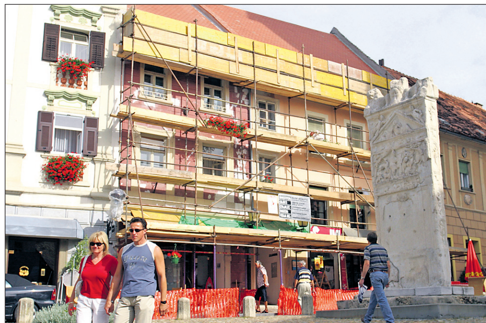
Na Slovenskem trgu obnavljajo dve fasadi, v kratkem bodo obnovili tudi eno od fasad v Slomškovi ulici.
