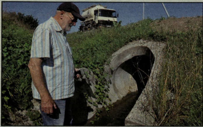
Pod avtocesto v Šentrupertu teče čista podtalnica, opozarja dr. Boris Skalin
