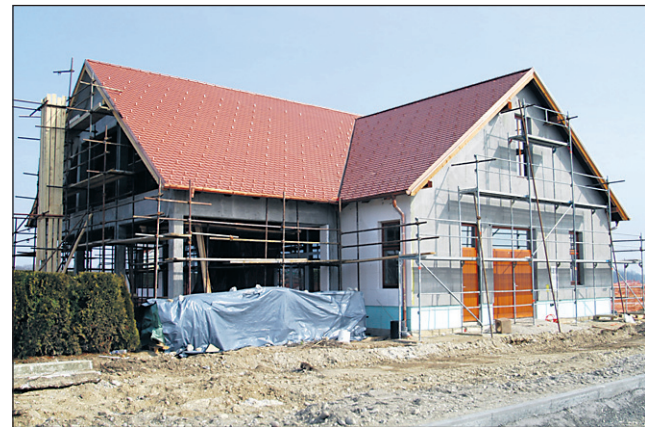
Tudi na novi mrliški vežici že izdelujejo fasado, urejajo pa tudi okolico s parkiriščem.
