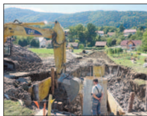
Kanalizacijsko omrežje se bliža čistilni napravi.
