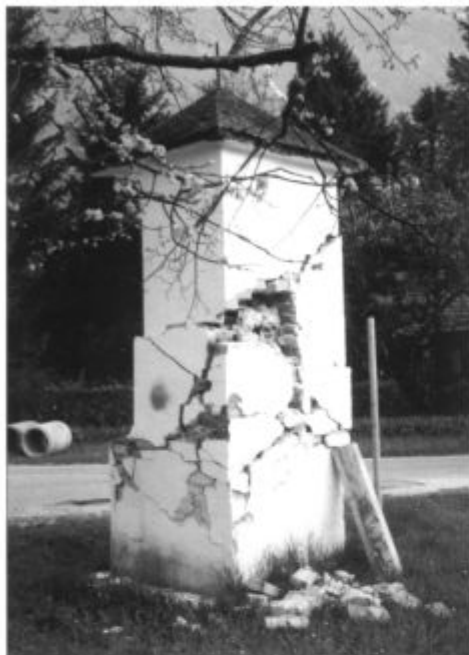
Porušena kapelica v Mali vasi v Bovcu. Poškodba je bila ocenjena z VIII. stopnjo po EMS (foto R. Vidrih).
