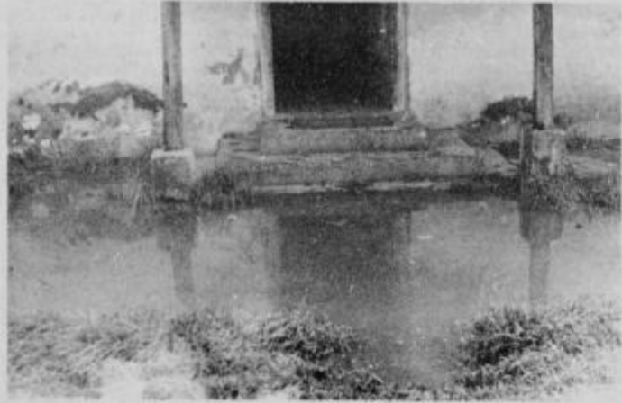
Takole je ob zadnjem deževju izgledal vhod v zgradbo št. 63
