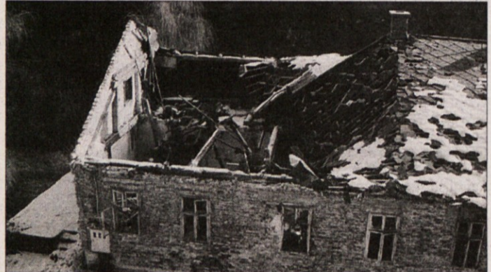
KOT BI TREŠČILA BOMBA - Tako klavrno podoba daje Flekov mlin v starem črnomaljskem mestnem jedru, odkar se je zaradi dotrajanosti streha pod težo snega in let zrušila. Črnomaljši si že dolgo želijo, da bi se končno kdo spopadel s to mestno sramoto. Kot je zagotovil direktor občinske uprave Božidar Brajkovič, naj bi se to v resnici kmalu zgodilo. (Foto: M. B.-J.)
