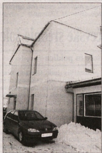
STARI DEL ŠOLE - Stari del šole, kjer še poteka pouk na nižji stopnji in vrtcu, je nevaren in po mnenju strokovnjakov neuporaben. Vlada dela svoje, zastrašujoče pa je videti tudi velike razpoke, ki jih je povzročil predlanski potres. (Foto: L. M.)
