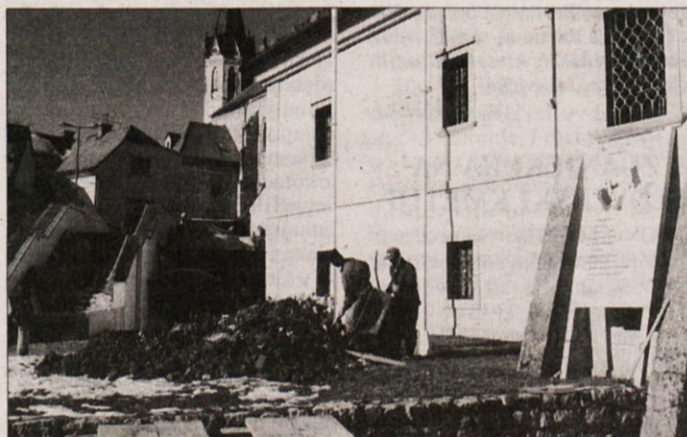
OBNOVA TEMELJEV KRIŽATIJE - Dolenjski muzej začel jubilejno leto, v katerem praznuje petdesetletnico svojega delovanja, tudi s prvimi gradbenimi deli pri sanaciji stavbe Križatije. V nji bo dobila nove prostore stalna arheološka zbirka, ki s svojimi zgodovinskimi dragocenostmi po pomenu presega lokalne in državne meje. Konec prejšnjega tedna so začeli odkopavati in obnavljati temelje. (Foto: MiM)
