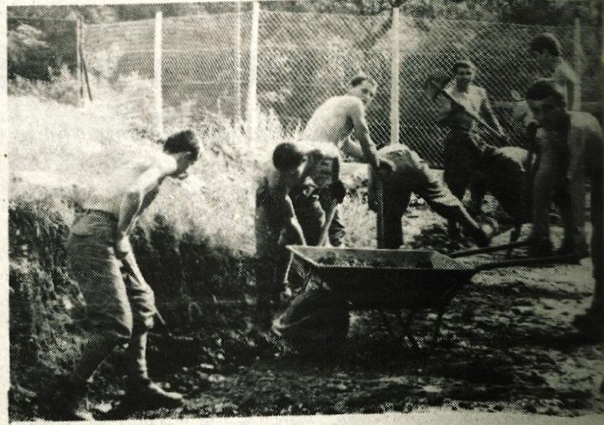
Delovna akcija — Mladinci tovarne Iskre iz Lipnice in vojniki 2. pionske čete iz Bohinjske Bele so avgusta organizirali delovno akcijo. Izkopali so 30 metrov dolg temelj, na katerem bodo stali skladišni prostori tovarne. Akcije se je udeležilo 27 vojakov in delali so kot prostovoljci. Poleg izkopa temelja so izravnali še sto kvadratnih metrov zemljišča. Po opravljenem delu so se mladi iz Iskre pogovarjali z vojniki o njihovem življenju in delu. (B. Solar) — Foto: Rado Obid
