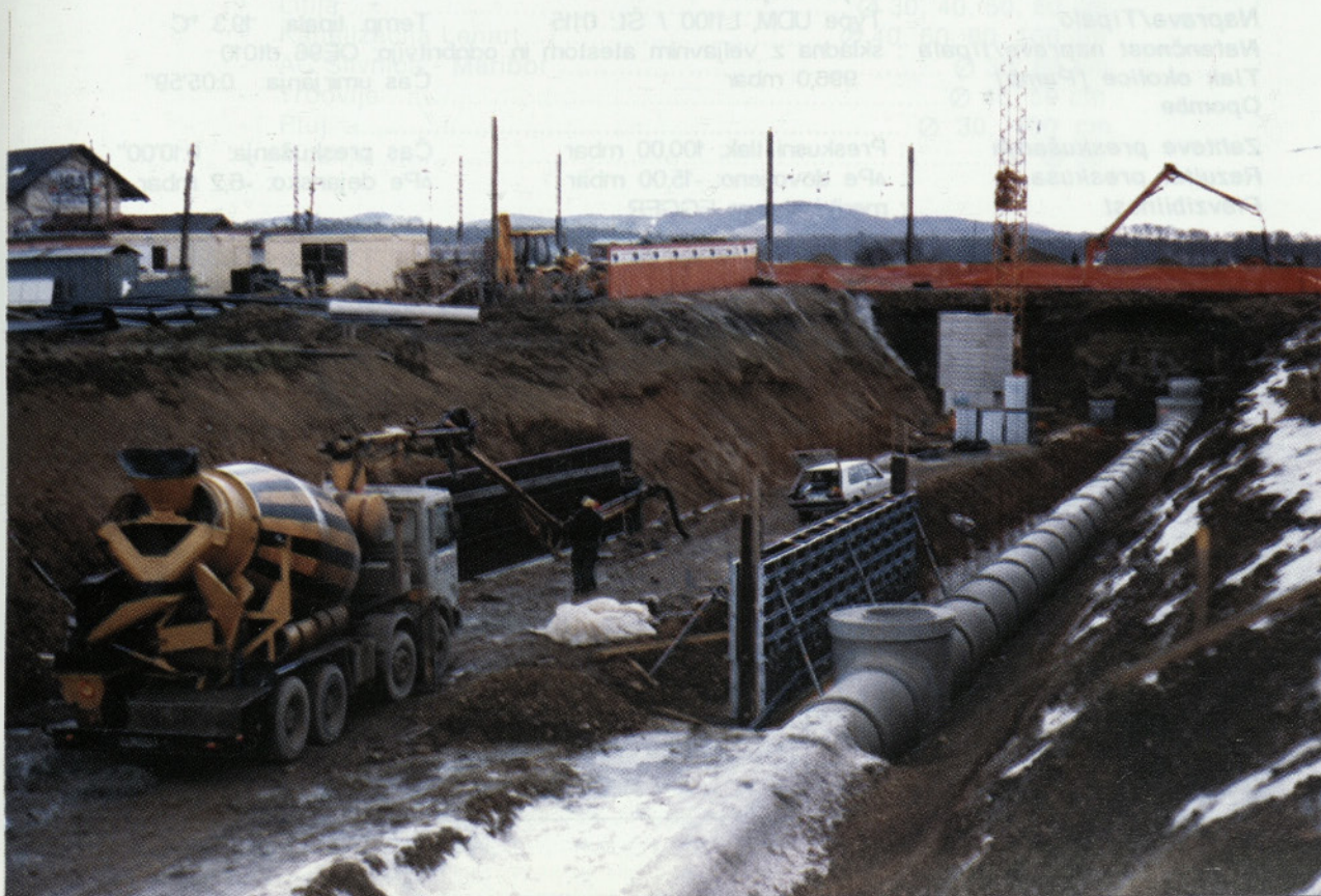
Slika 7: kanalizacija \varnothing 100 na Miklavški v Hočah
