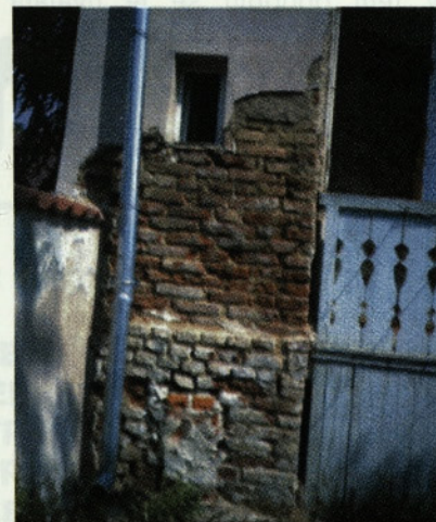
Sliki 4 in 5: Primer sanacije vlage s sušilnimi elementi
