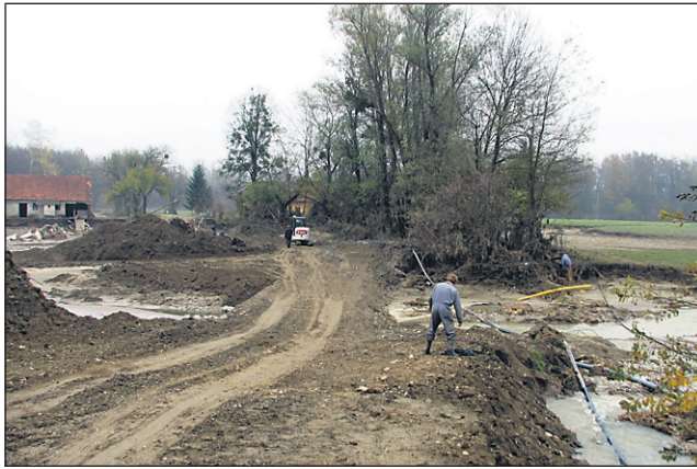
Povečan pretok Drave v začetku tega tedna je v Forminu odnesel postavljen začasni most in cesto do farme z 80.000 piščanci; v teh dneh že urejajo vse na novo.
