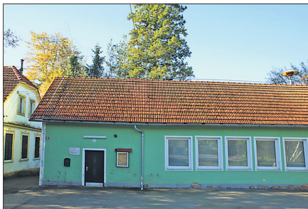
Po sklepu sveta ČS Panorama Doma krajanov Olge Meglič ne bodo obnavljali glede na visoke stroške sanacije, ki presegajo 60 tisoč evrov.
