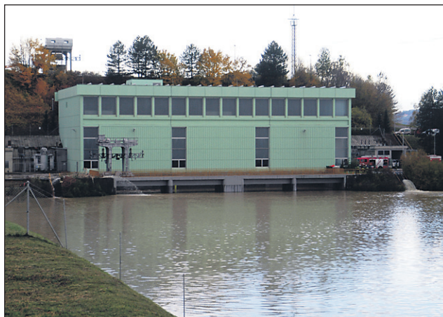
Pogled na strojnico HE v Forminu v torek zjutraj, potem ko so jo delno zalile poplavne vode, desno je vidno gasilsko vozilo in curek vode med izčrpavanjem iz notranjosti.
