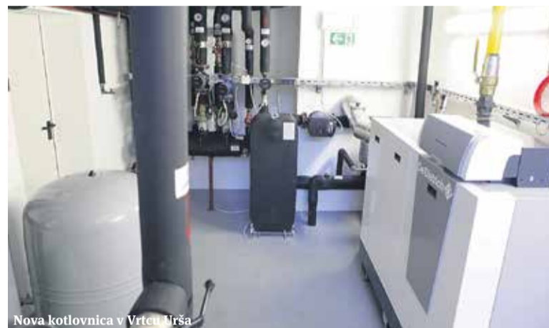
Nova kotlovnica v Vrtec Urša
