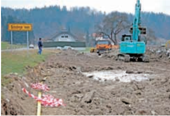
Gradbišče v Srednji vasi, kjer delavci polagajo cevi za kanalizacijo in vodovod. / FOTO: GORAZD KAVČIČ
