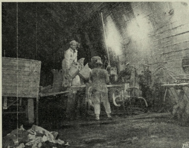
Injekcijska postaja v predoru (z aparatom)
