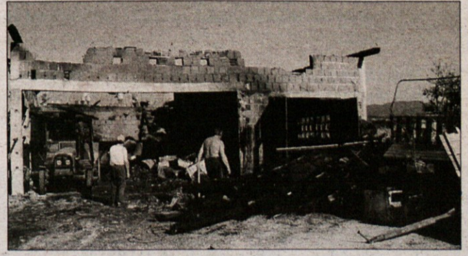
SOTLERJEVO POGORIŠČE - Požgano gospodarsko poslopje kaže žalostno podobo. Najprej bo treba poskrbeti za novo streho. (Foto: L. M.)
