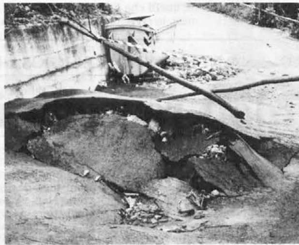
Tudi v Seuc uoda je uzdiglna asfalt
