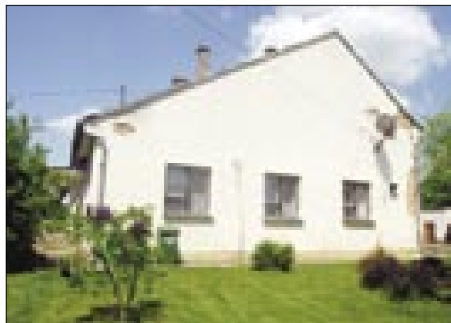
Kulturni dom na Verici je rejsan potreben obnove
