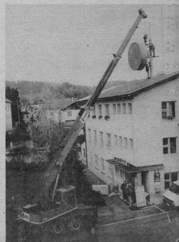
Na strehi mozirske pošte se že nekaj dni bohota velika antena za radio-relejni povezavo Sv. Križ — Mozirje — Celje, ki bo omogočala 300 brezžičnih medkrajevnih telefonskih zvez za Zgornjo Savinjsko dolino. Ta antena je bila pogoj za vključevanje končnih avtomatskih telefonskih central v vozliščno centralo v Mozirju in naprej v glavno centralo v Celju. Antena je bila v celoti financirana iz sredstev samopriskpevka, vrednost antene pa je 70 milijonov din.
