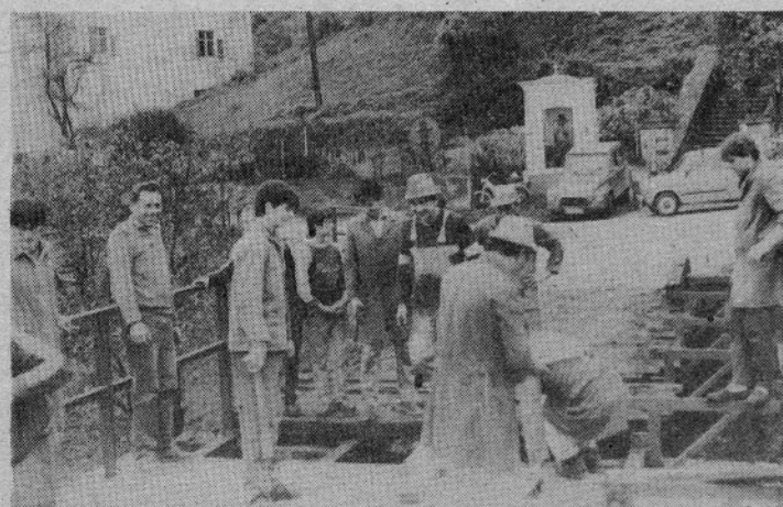
Tudi v KS Nazarje ne mirujejo. Večjih in manjših nalog jim ne manjka. Tako so z udarniško akcijo v celoti obnovili zares dotrajan in že nevaren most preko Drete. Obnova mostu je bila financirana iz sredstev samopriskpevka, pomembna pa je bila pomoč številnih krajanov od Nazarja do Dobrovelj, ki so delo udarniško opravili v rekordnem času. Omenimo še, da so v zadnjem času asfaltirali cesto Lačja vas—Gorica in odsek ceste v Žlabu (Mlinar—Jošk). Postavili so tudi lične lesene smerokaze, ki na nevidljiv način opozarjajo in usmerjajo obiskovalce do vasi in zaselskov ter do znamenitosti na tem področju.
