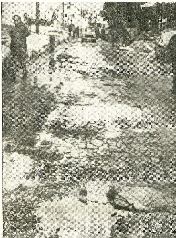
Po ukinitvi gornjesavske proge je cesta izredno obremenjena. Zato ni čudno, da je sedaj, ko je odlezel sneg na mnogih krajih tako »vzcvetela«, da jo bo prav težko popraviti. Na sliki: Kranjska gora te dni
