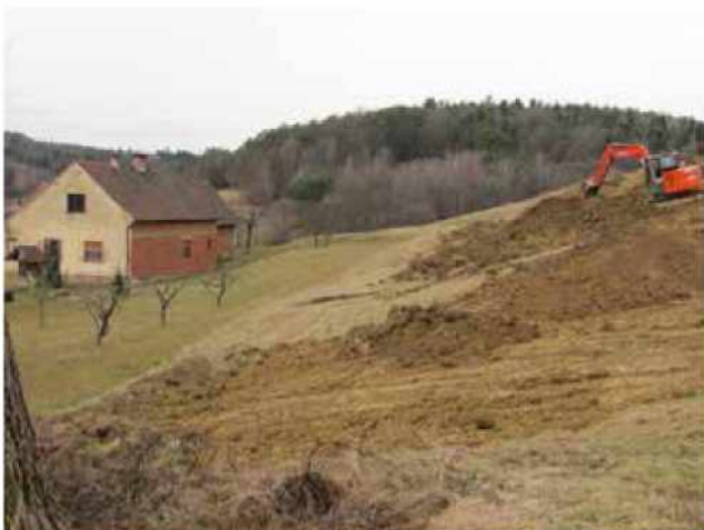
Plaz nad hišo Horvatovih v Boreči
