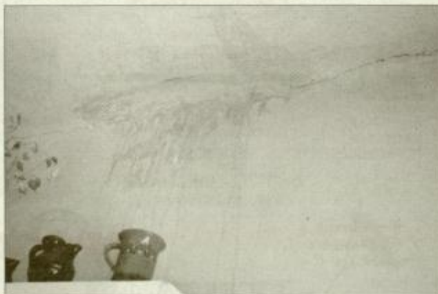
Takšnih razpok je ogromno na stenah v hiši Peerovih in Mlakarjevih.
