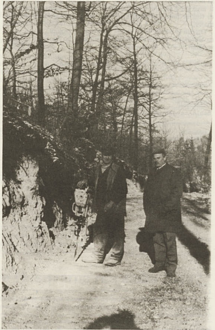
Tozd gozdarstvo Novo mesto gradi cesto Črno lice - Krči v lastni režiji. Ob vodji TOZD ing. Vladu Pavcu stoji Stanko Zagorc z vrtalnim strojem. (Foto Mirko Bajt).
