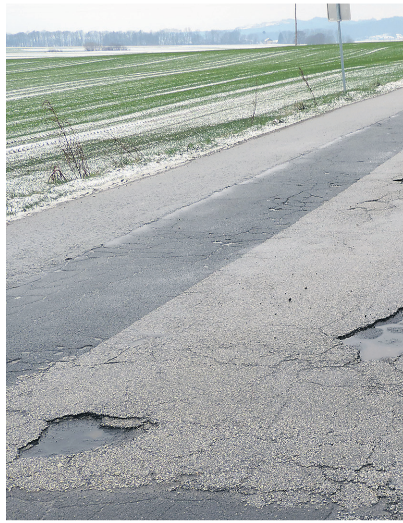
Na Ormoškem je med najbolj poškodovanimi cesta Velika Nedelja-Savci, ki je na
