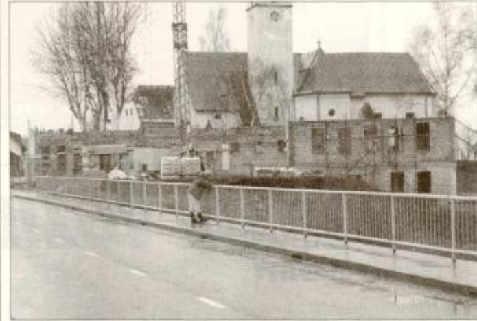
Obris občinske stavbe v Vidmu so že vidni. Dela izvaja zasebno gradbeno podjetje Korpar.
