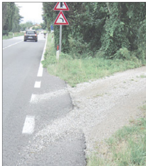
Grušč, ki ga avti vnašajo na vozišče državne ceste
