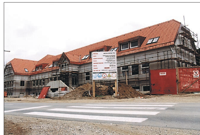
Rekonstrukcija in dozidava OŠ Grajena vse bliže koncu. Pogled na novo šolo s ceste strani. Foto: Črtomir Goznik
