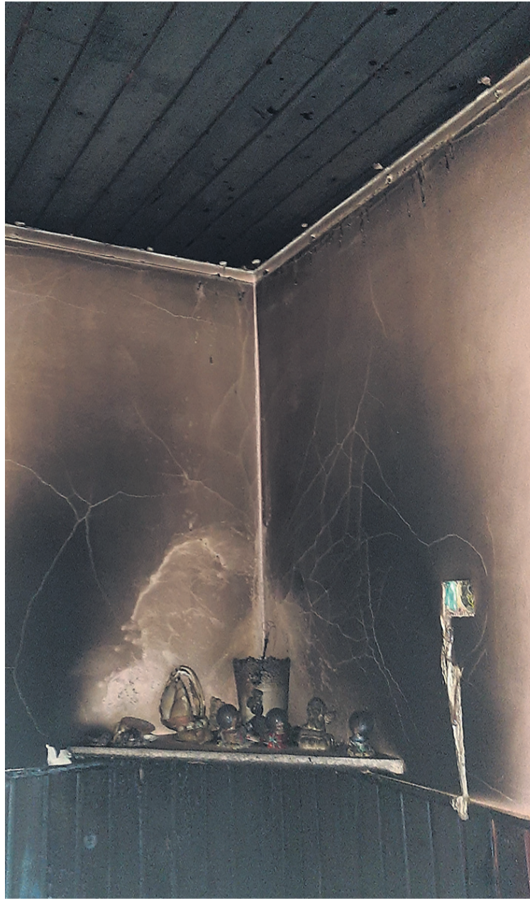
Gorelo je že tudi po steni in stropu nad klopjo.
