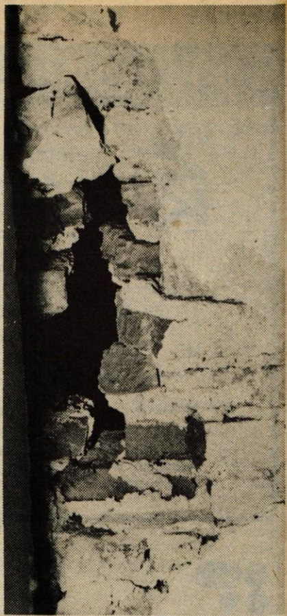
Objekte s takšnimi razpokami so morali zapreti
