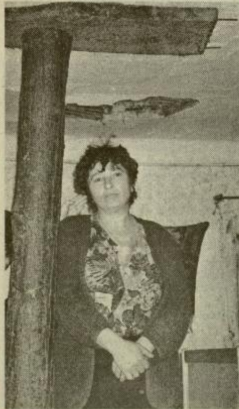
Podporni tram v spalnici za zdaj še preprečuje, da bi se strop utrujeno sesedel.
