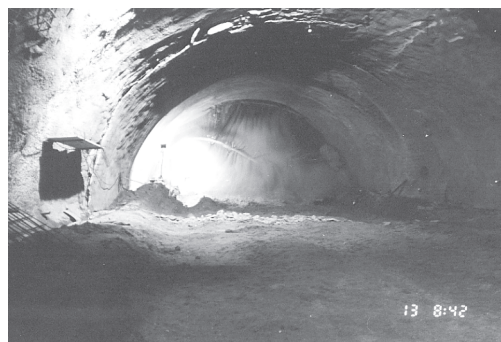
Slika 3: Zrušek na st. 55+329 v fazi sipanja največje količine materiala 13.2.2000 ob 8uri 42 minut. Lepo vidna razpoka v primarni oblogi (levo).
