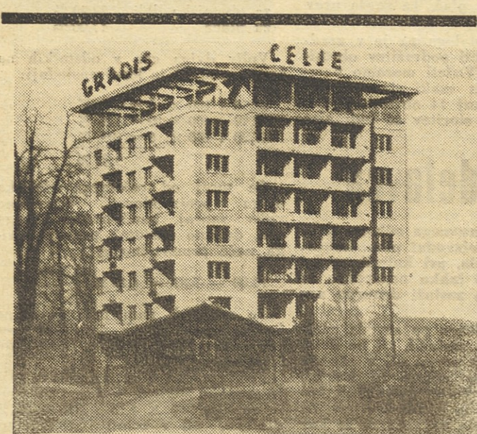
V Celju bodo prvega slavnostno odprli novo upravno poslopje, ki stoji tik izza sedanje barake. V njem je še 40 stanovanj, v zgornjem nadstropju, iz katerega je čudovit razgled na Celjski grad, je restavracija. V njej se bodo hranili vsi delavci celjskega gradbišča. Imeli pa bodo to prednost, da ne bodo plačevali tistih 13 odstotkov režije, ki jo sicer zaračunavajo k hrani. Vsak večer bo v restavraciji tudi kino, predstava, v dogovoru pa so še s številnimi kulturniki in potujočimi kulturno umetniškimi skupinami za gostovanja v novem domu. Zgradba je stala le 30 milijonov dinarjev, ker se jo gradili večinoma s prostovoljnimi delci.
