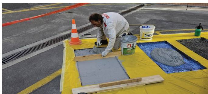
Slika 12. Izdelava dvoslojnih tankih plošč iz drobnnozrnatega mikroarmiranega betona; iz referata z naslovom Tankoslojni elementi in preplastitve.
