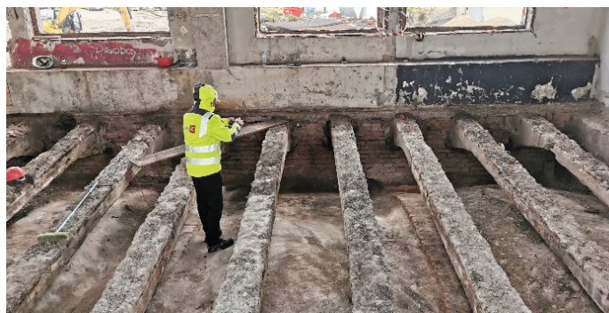
Slika 7. Obstoječi nosilni elementi medetažne konstrukcije (foto: arhiv Elea iC, d. o. o.).
