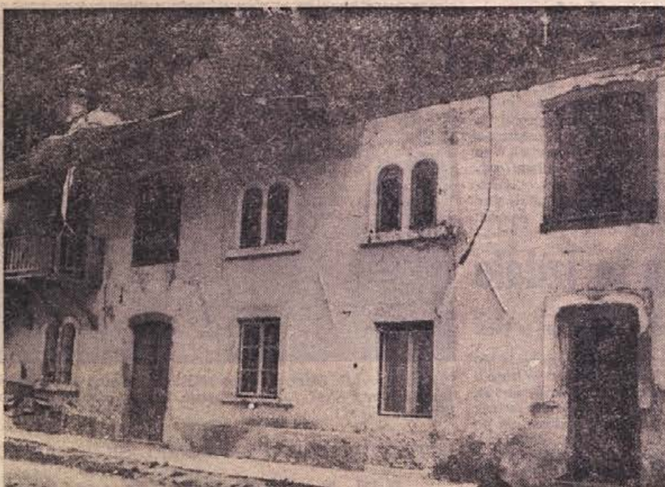
Na nekaterih poslopih ortneškega gradu se je preteklo zimo podrla streha. Strešno konstrukcijo gradu bi bilo treba čimprej obnoviti, ker jo bo drugače doletela enaka usoda (Foto: Primc)
