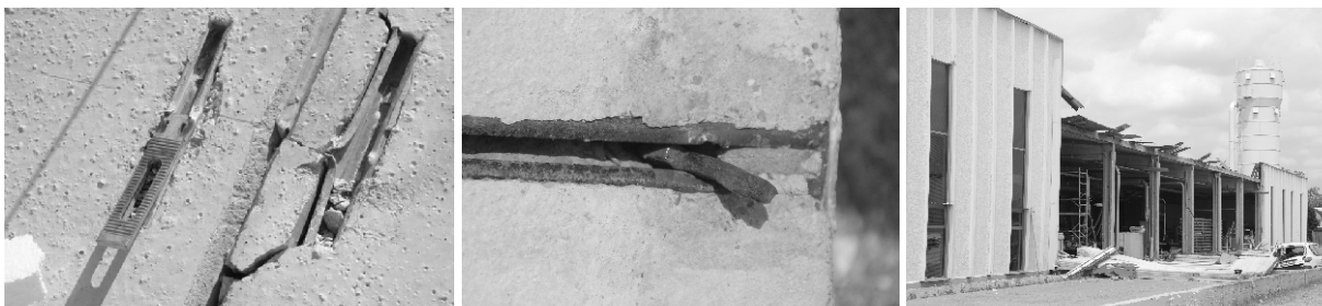
Slika 1.7: Porušitev tipičnih stikov med panelom in konstrukcijo med potresi v L'Aquili (2009) in pokrajini Emilija - Romanja (2012).
