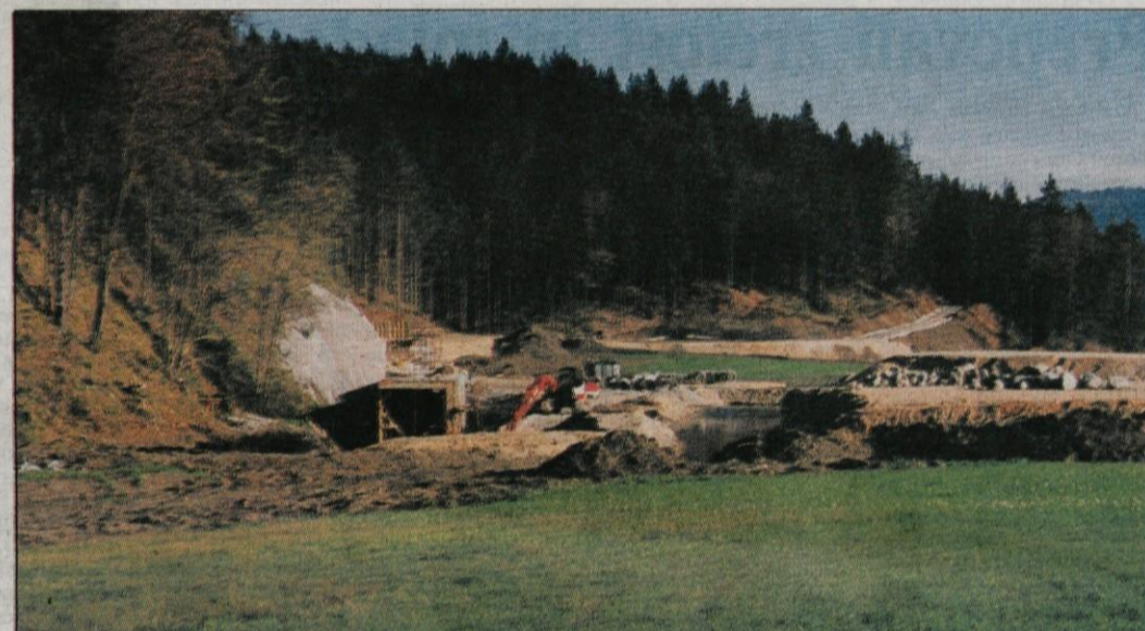
Obiskala pa sem tudi gradbišče v sosednji občini, kjer urejajo zadrževalnik Drtiščica, ki bo pomembno vplival na vodne razmere v naši občini. Če dobro pogledate fotografijo, boste ob veliki skali na levi že lahko opazili začetek zapornic, s katerimi bodo regulirali stanje vode v bodočem zadrževalniku.
